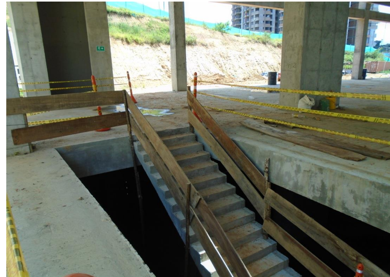
InstAlación de pasamanos en madera como medida de prevención en seguridad industrial
